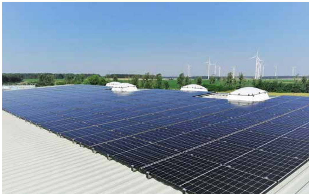
EMIS plant und realisiert PV-Anlagen auf Freiflächen und auf Dächern – so wie hier bei LKT in Luckau.
